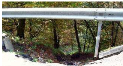
Un altro punto in cui la carreggiata risulta erosa e danneggiata
