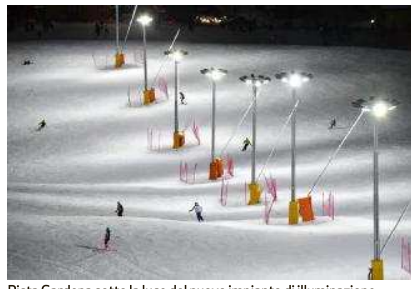
Pista Gardena sotto la luce del nuovo impianto di illuminazione
