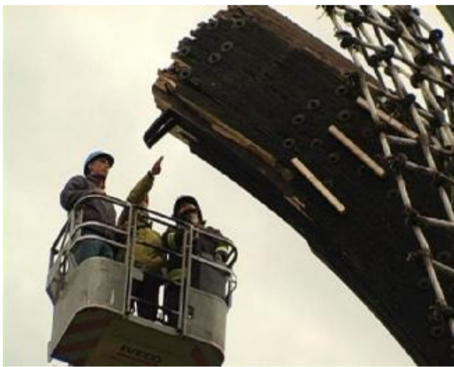
Le perizie sulla croce spezzata effettuate subito dopo il crollo
