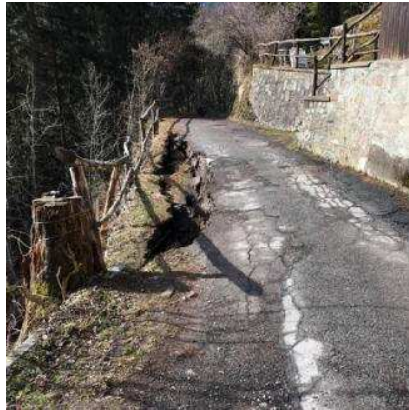
Il tratto di strada comunale di Bienno interessato dal cedimento
