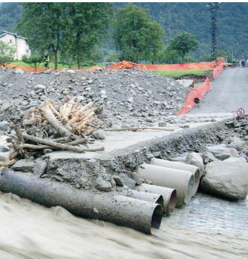
Rino di Sonico. La frana che colpì il paese nel luglio 2012
