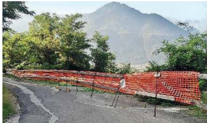
Pericolante. Un tratto della strada che porta alla frazione Acquebone
