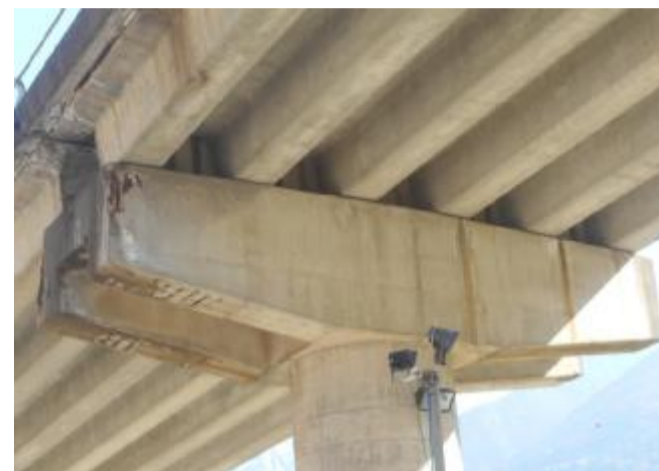
Uno dei distacchi di calcinacci registrati lungo la superstrada
