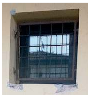
Via d'accesso. La finestra violata
