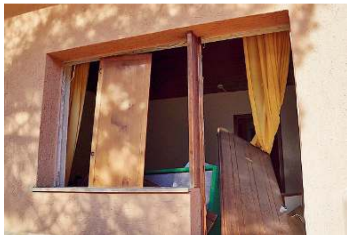
Devastazione. Una delle camere dell'hotel devastate dai vandali
